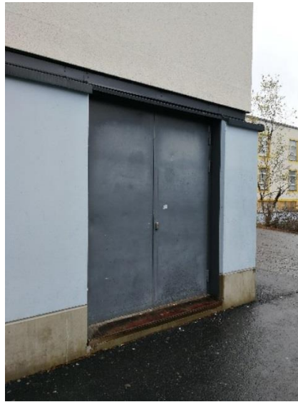
Kuva 8. Kynnys vaurioitunut kosteudesta.
