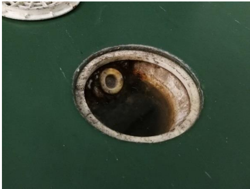
Kuva 5. Märkätilojen kaivot ovat melko vanhoja ja niissä voi olla epätiiveyskohtia.
