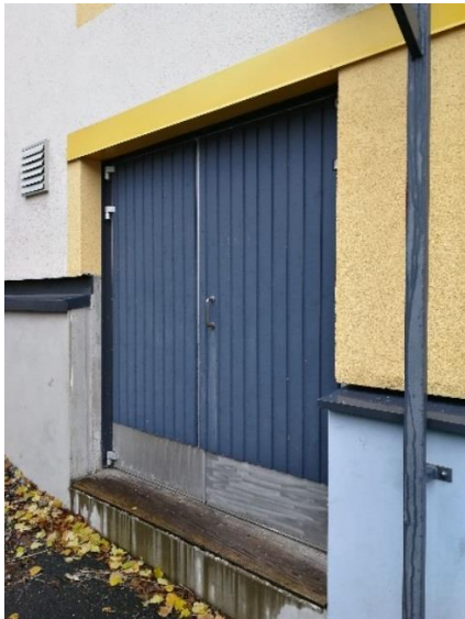
Kuva 7. Kynnys vaurioitunut kosteudesta.
